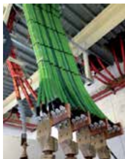
Cables afectados por el CPR.
